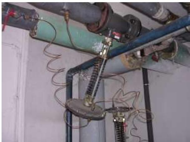
Regulátor diferenčního tlaku na patě objektu
