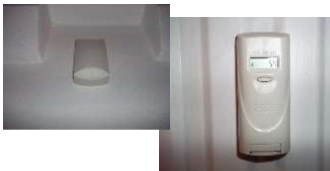
RTN DOPRIMO III (Symfonic III) s možností dálkového sběru dat - příklad sběrnice umístěné na chodbě domu
