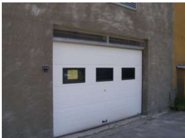
Garáže I. Olbrachta – dálkově ovládaná vrata v 1.N.P.
